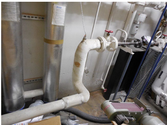
Foto 3: Rör/rörböjar isolerade med asbest.
