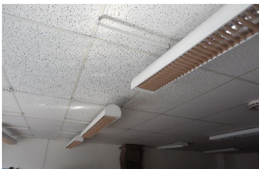
Foto 4: Ex. på lysrörsarmaturer.
