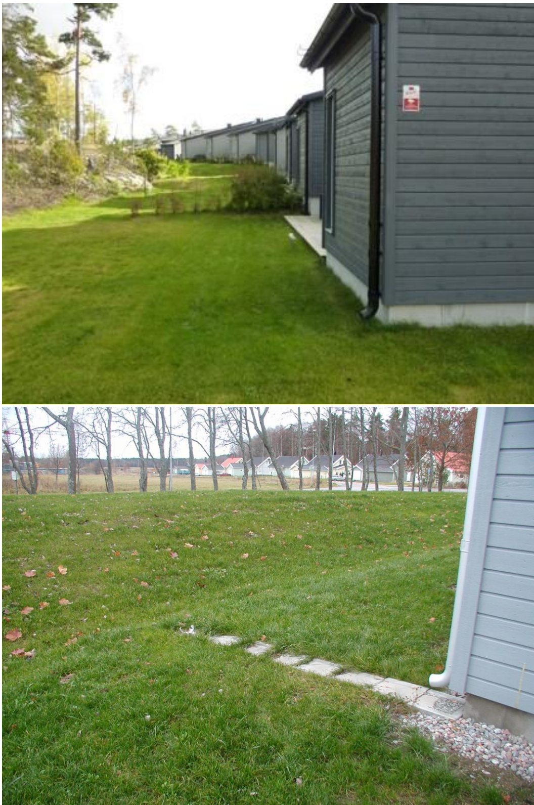
Figur 8. Två exempel på stuprör med utkastare mot grönyta. Vattnet kan infiltrera i grönytan och vid större flöden avleds vattnet yttleds mot ett svackdike (t.v. i bild). Foto: WRS
